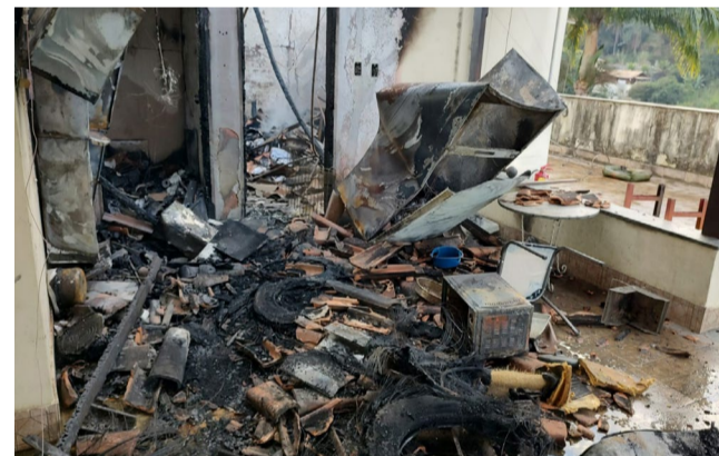
Situação do local após o incêndio ser controlado pelos militares do Corpo de Bombeiros (crédito da foto: Diego Simam/ Líder Notícias)
