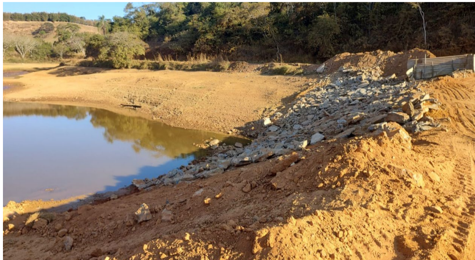
Para a construção do reforço da barragem foi preciso esvaziar a lagoa (crédito da foto: Diego Siman/Líder Notícias)
