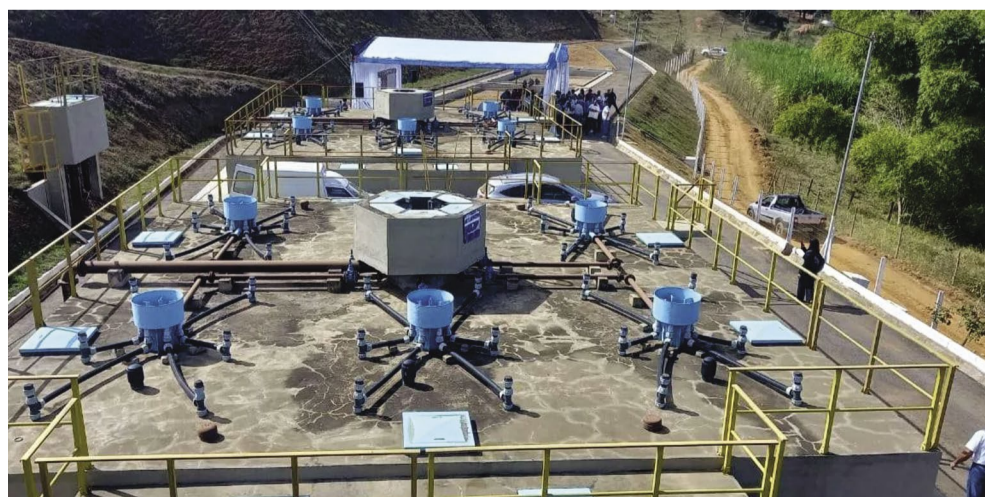
Copasa inaugurou sua ETE (Estação de Tratamento de Esgoto) em junho, na cidade de Viçosa (crédito da foto: divulgação Copasa)
