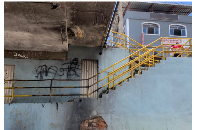
Espaço debaixo da Ponte Dr. Francisco Linares Ribeiro servia de apoio aos servidores da Semash e se encontrava deteriorado até a data da limpeza (crédito da foto: divulgação da PM)
